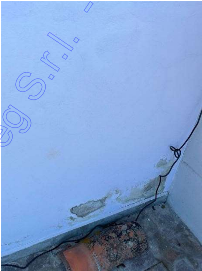
Foto 14 : Dettaglio umidità di risalita
