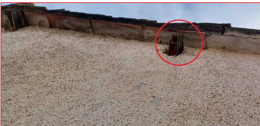
Foto 15 - Particolare travi deteriorate del tetto
