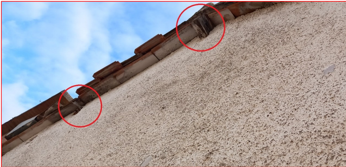
Foto 14 - Particolare travi deteriorate del tetto
