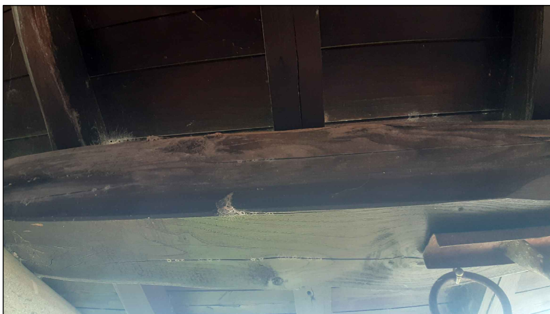
foto 10 - altra vista della presenza di tarli sulle orditure lignee principali e secondarie del porticato.
