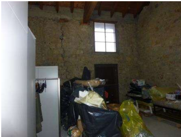
22a - 1°P distacco muratura sopra ex porta morta
