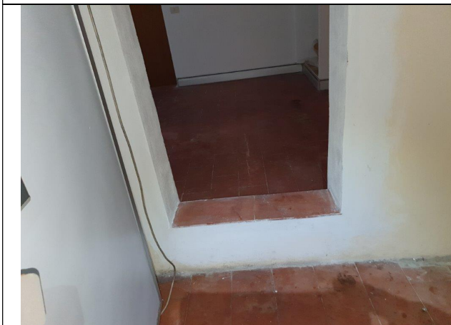
Foto 21 – P.T. porta di comunicazione cantina-altra unità
