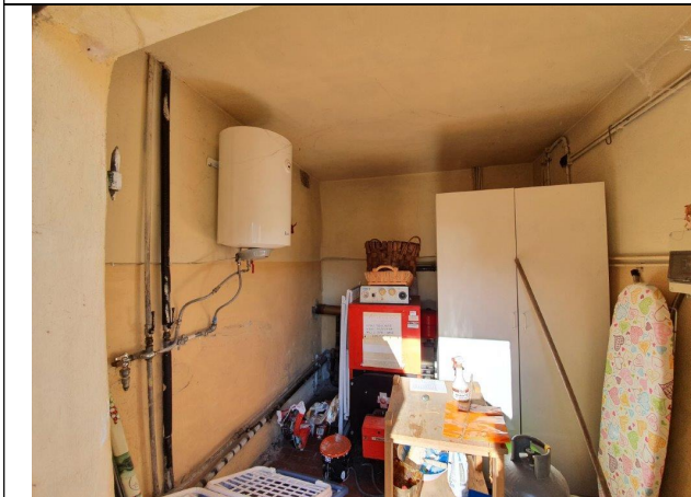
Foto 41 – P.T. Centrale Termica
