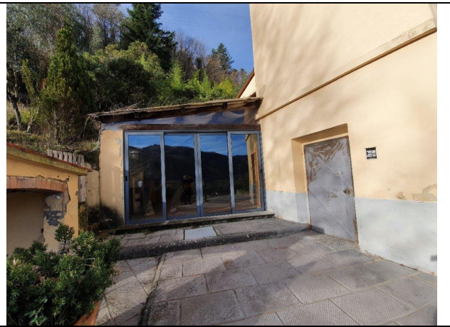
Foto 8 – Ingresso centrale termica
