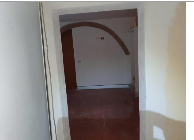
Foto 22 – P.T. porta di comunicazione cantina-altra unità
