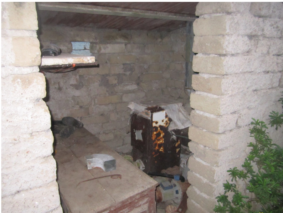
Immagine 20 _ Vista interna del locale caldaia. Visibile all'interno la caldaia in rovina.
