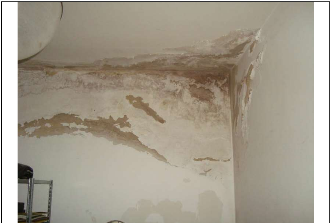
Foto n° 43. – Particolare infiltrazioni da copertura – via per Canicattini n.18
