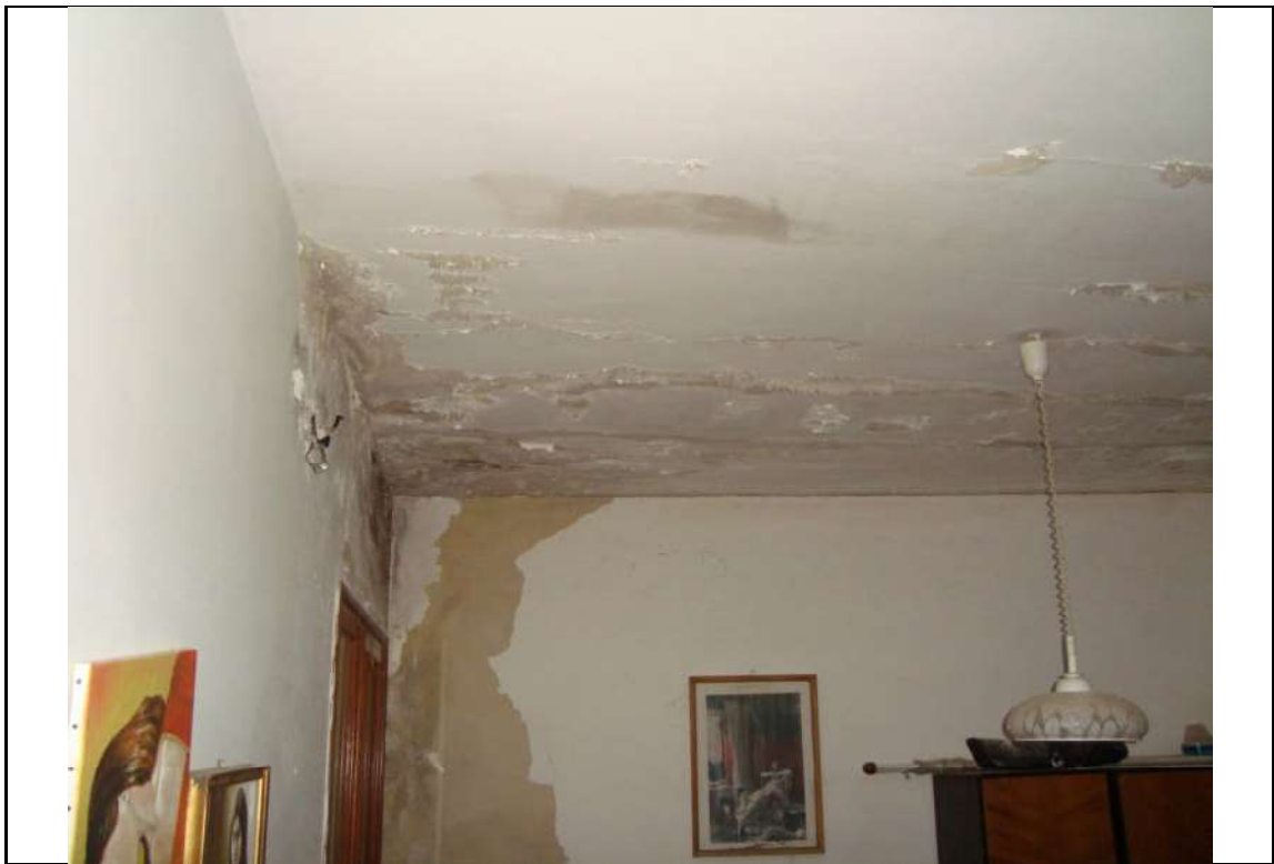
Foto n° 41. – Particolare infiltrazioni da copertura – via per Canicattini n.18
