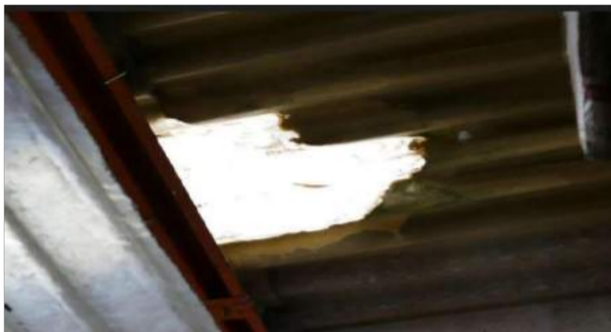
Particolare fotografico parte di copertura degradata in lastre di fibrocemento-amianto
