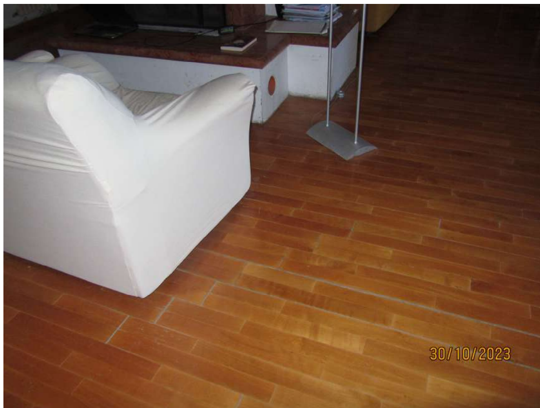
FOTO 8 - PARTICOLARE DELLO STATO DI CONSERVAZIONE DEL PARQUET.
