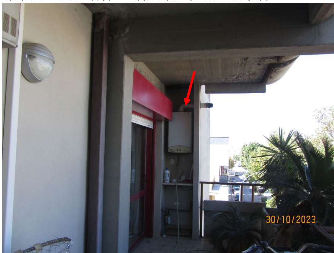
FOTO 14 - IDEM C.S. - POSIZIONE CALDAIA A GAS.
