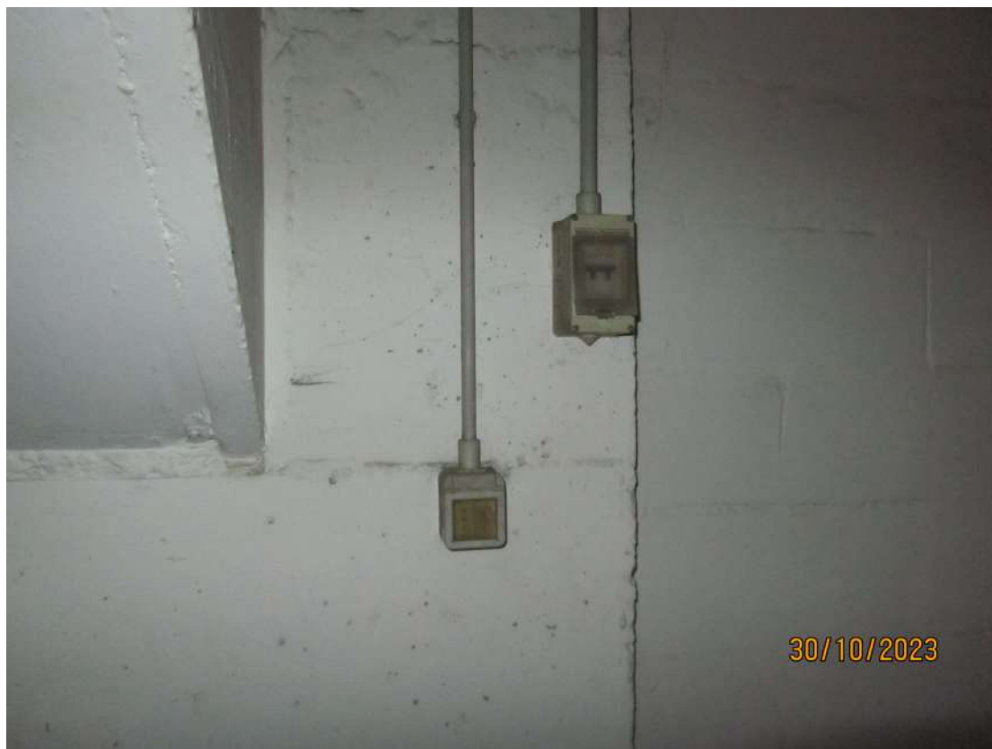
FOTO 20 - PARTICOLARE LINEA ELETTRICA INTERNA AL BOX AUTO.
