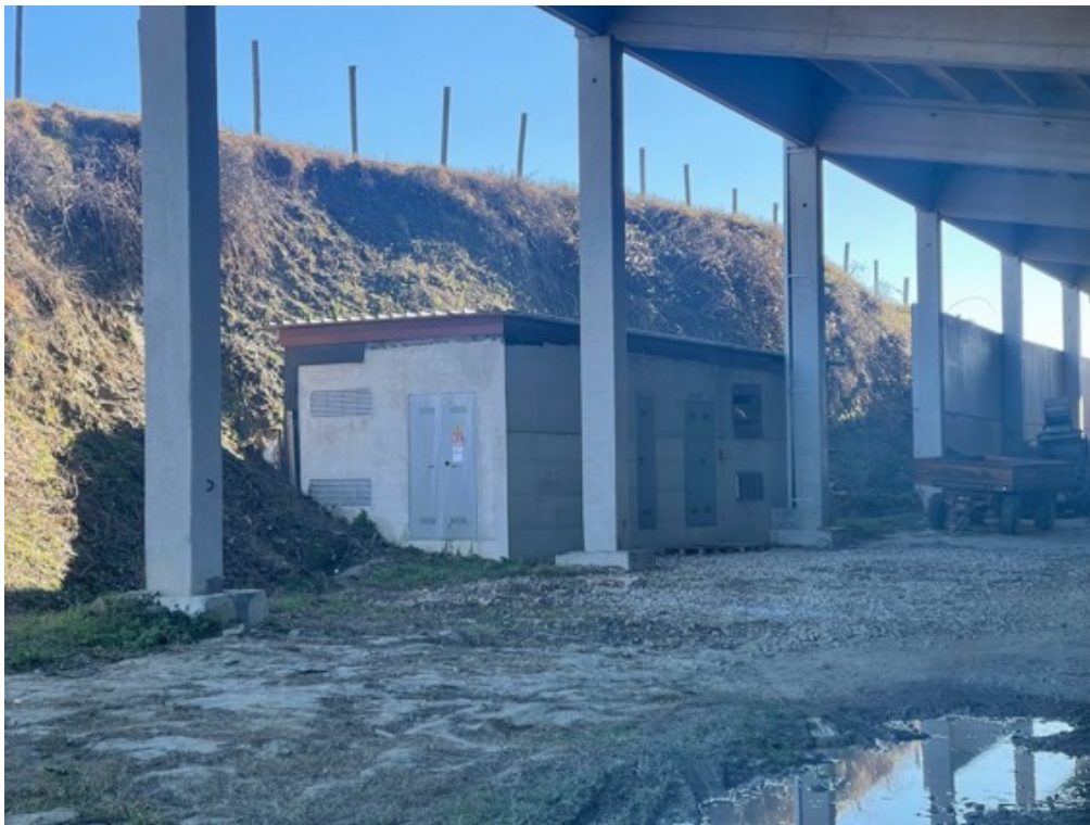
Fotografia A.8 - Cabina Enel (sub. 4)
