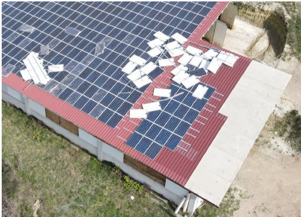
Fotografia A.14 - zona danneggiata colpita da evento atmosferico rilevante (pannelli fotovoltaici e manto di copertura)
