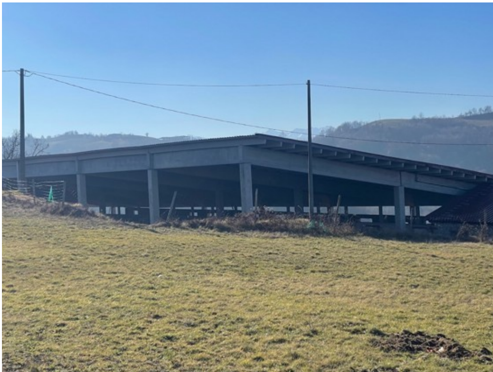
Fotografia A.6 - vista porzione copertura in parte difforme
