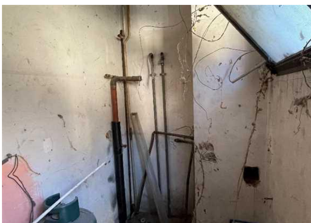
Vista della centrale termica
