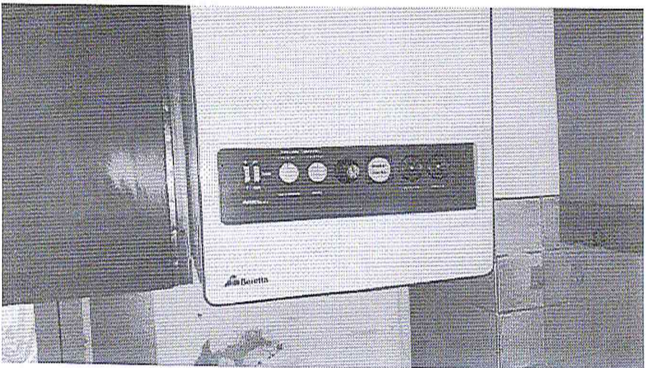
Particolare caldaia murale
