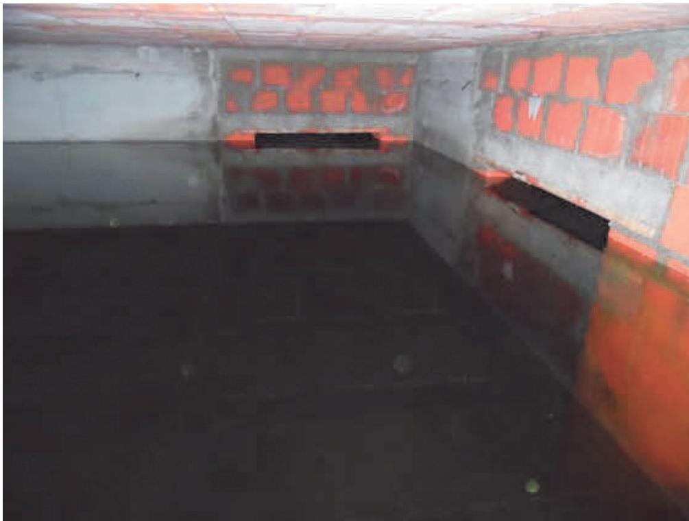
Fotografia E.12 - Vista del piano seminterrato dal vano scala centrale (completamente allagato)
