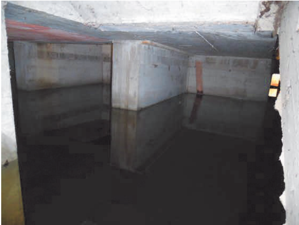
Fotografia E.13 - Vista del piano seminterrato dal vano scala (completamente allagato)
