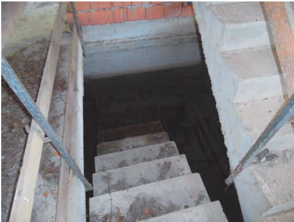
Fotografia E.14 - Vista del vano scala (si noti l'allagamento alla quota del piano seminterrato)
