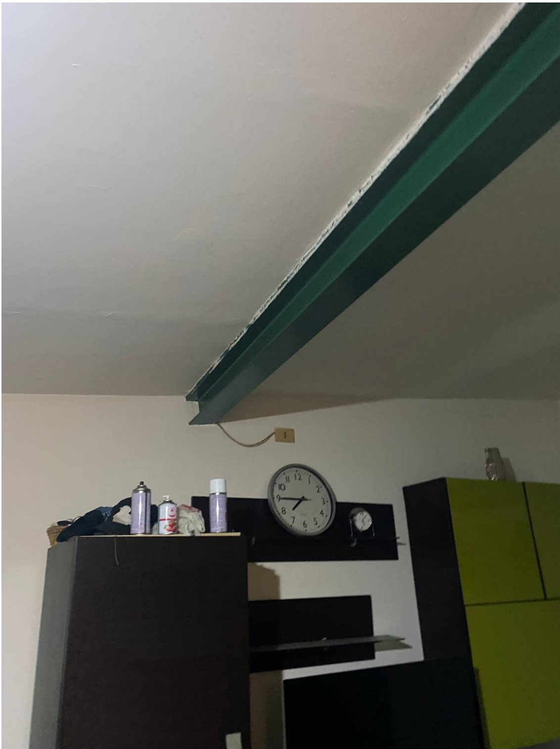
Fot. 11 – Vista della zona soggiorno con sovrastante la trave strutturale trasversale in acciaio.
