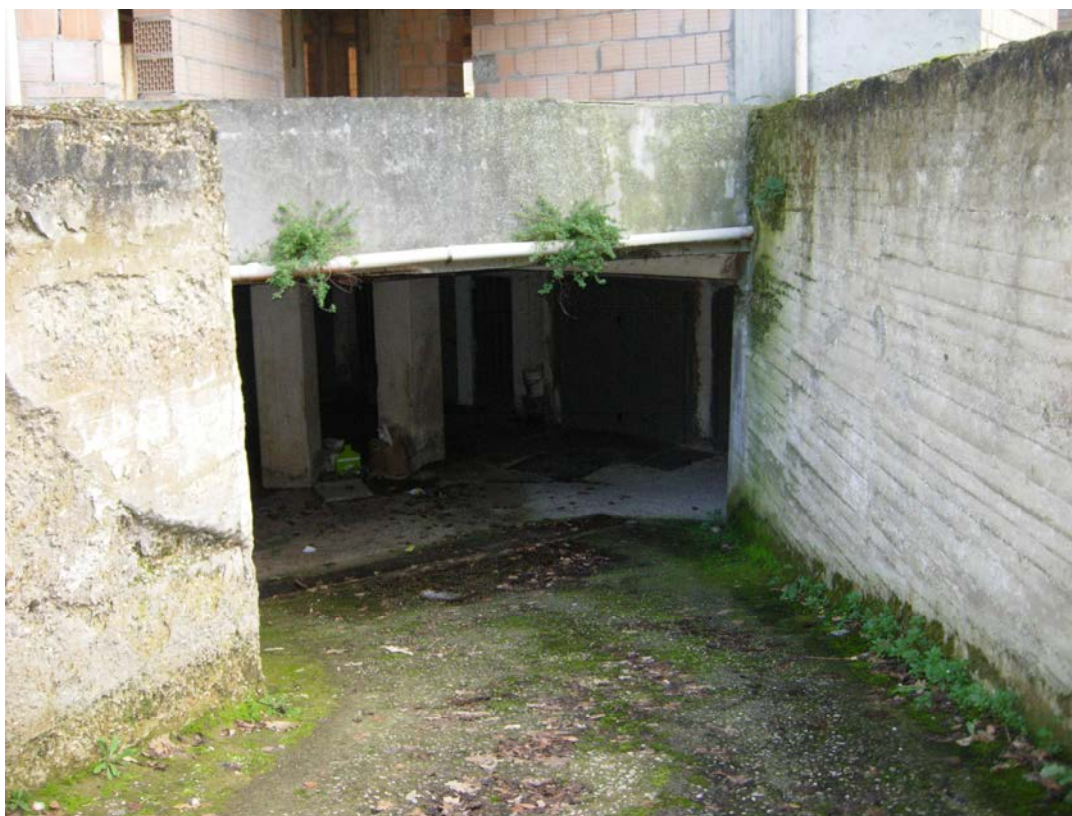
Foto 16 – Rampa di accesso al piano interato del fabbricato in cui si trovano la cantina ed il garage del debitore esecutato
