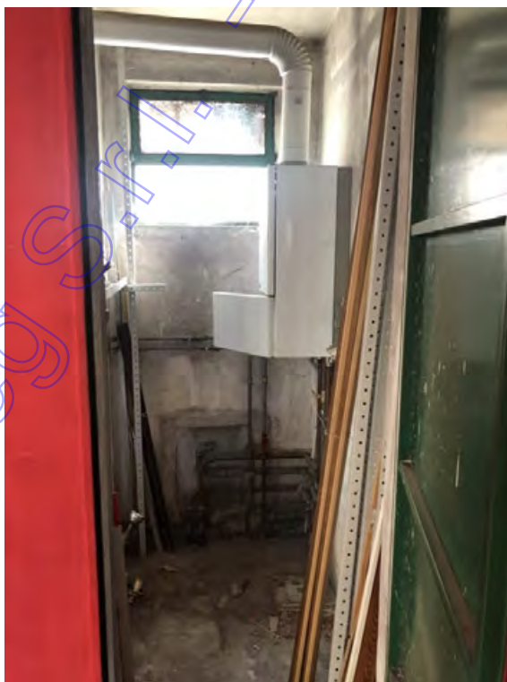
Fotografia A.17 - Particolare centarle termica PT
