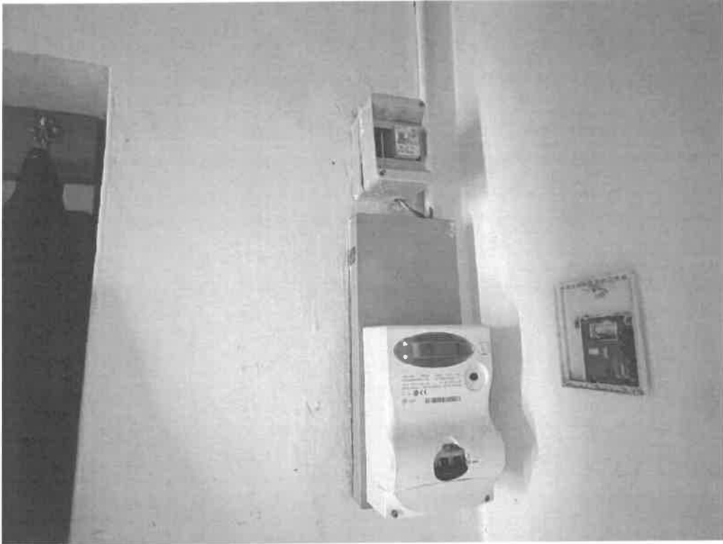
Figura 9 particolare impianto elettrico
