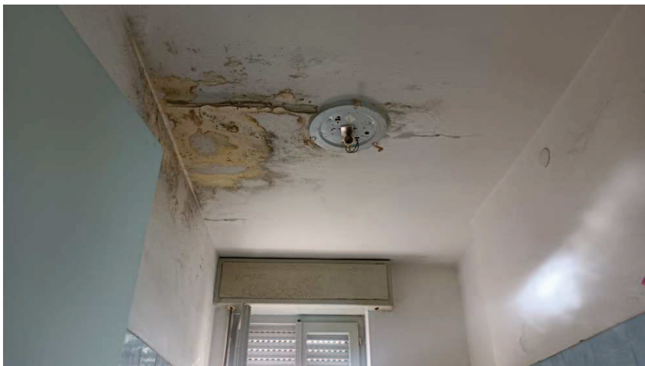
Foto n. 30. Vista del soffitto del bagno.
