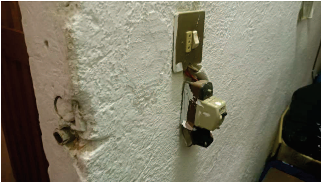
Foto n. 6. Impianti nella cantina.
