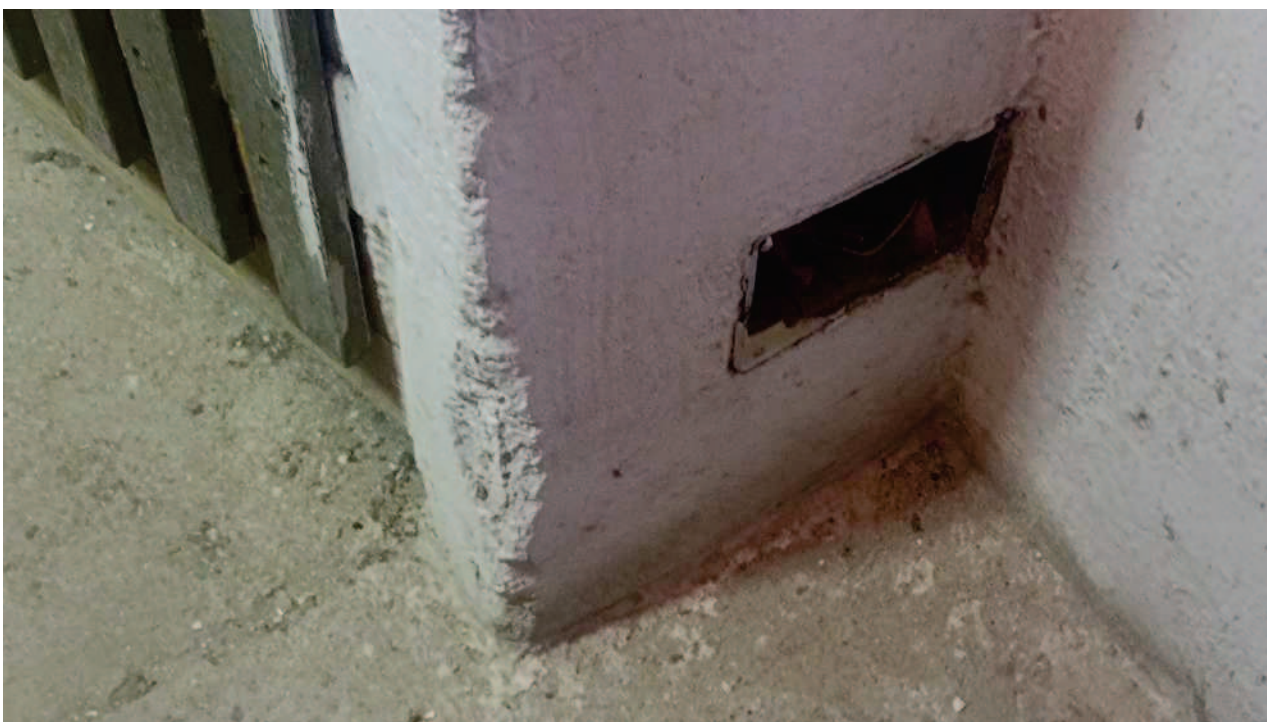
Foto n. 7. Impianti nella cantina.
