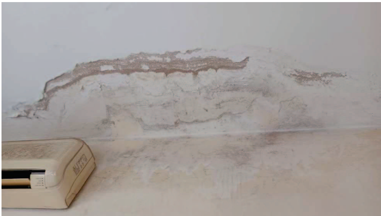
Foto n. 33. Particolare del soffitto della camera adiacente al bagno.
