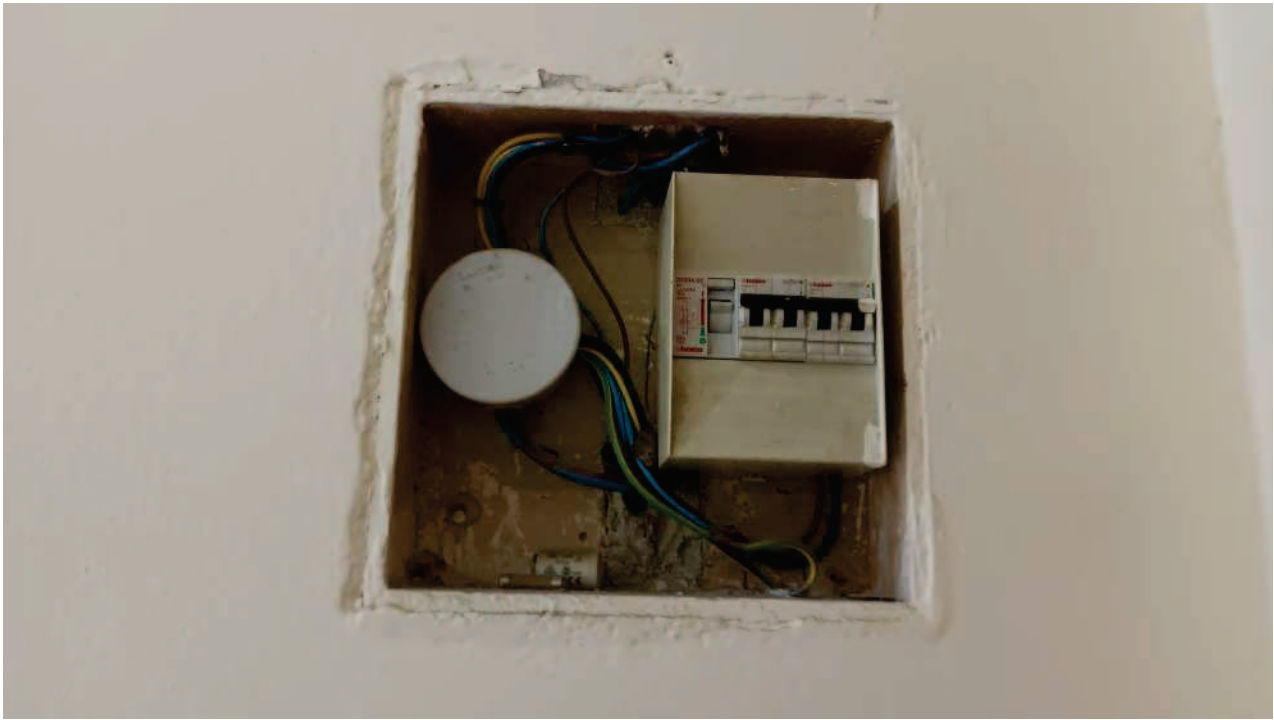
Foto n. 27. Quadro elettrico presente nel disimpegno, in prossimità della porta del bagno.
