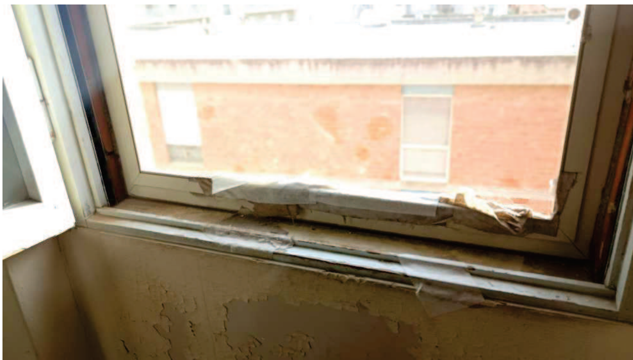
Foto n. 34. Particolare infisso della camera adiacente al bagno. La parte vetrata del parapetto dell'infisso é stata coperta con un pannello di legno, su cui la tinteggiatura é in fase di distacco.
