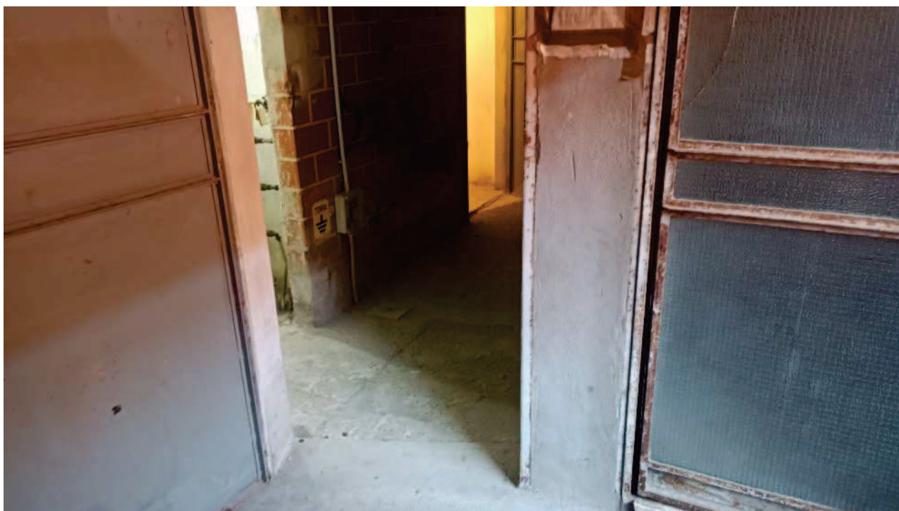
Foto n. 10. Vista dei locali contatori. Il primo a sinistra é riservato a quelli idrici, l'altro ai contatori Enel.
