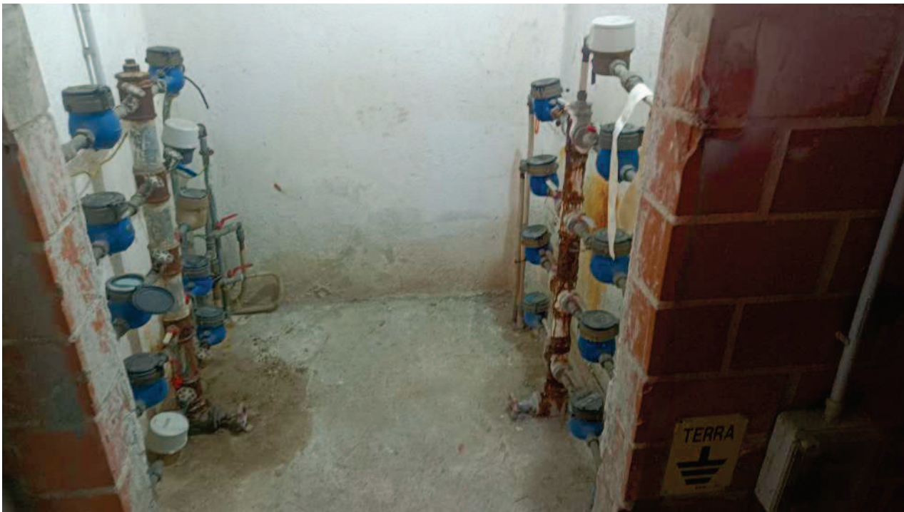
Foto n. 11. Vista del locale contatori idrici.
