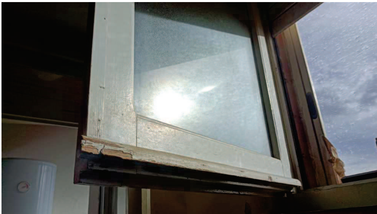
Foto n. 11. Particolare della finestra in legno della cucina. L'infisso necessita di un intervento di manutenzione.
