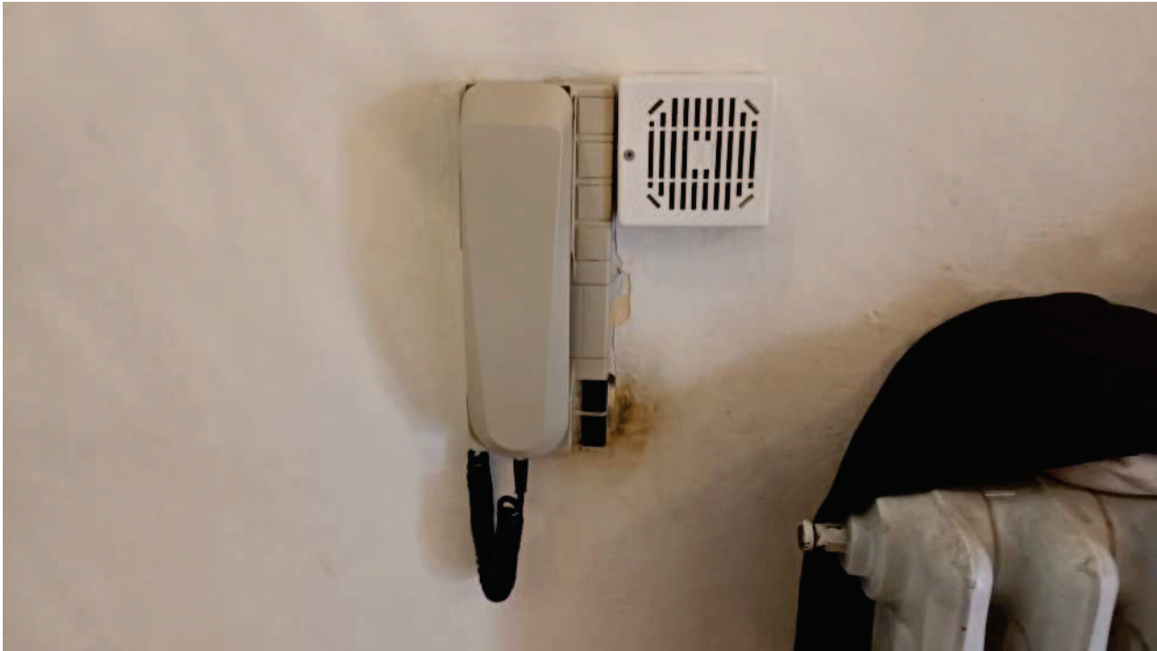
Foto n. 9. Impianti presenti nel soggiorno, in prossimità dell'ingresso.
