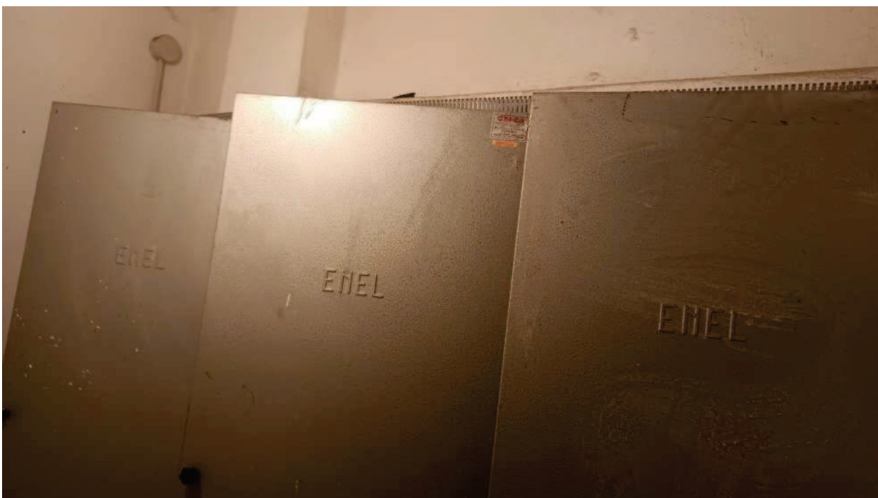
Foto n. 12. Vista del locale contatori Enel. Nell'ultimo armadio si trova quello dell'immobile.
