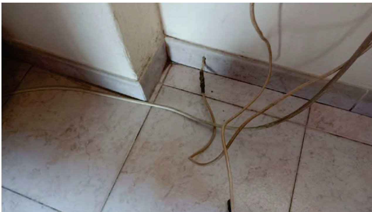
Foto n. 40. Particolare impianto nella zona sottostante la finestra della camera matrimoniale.
