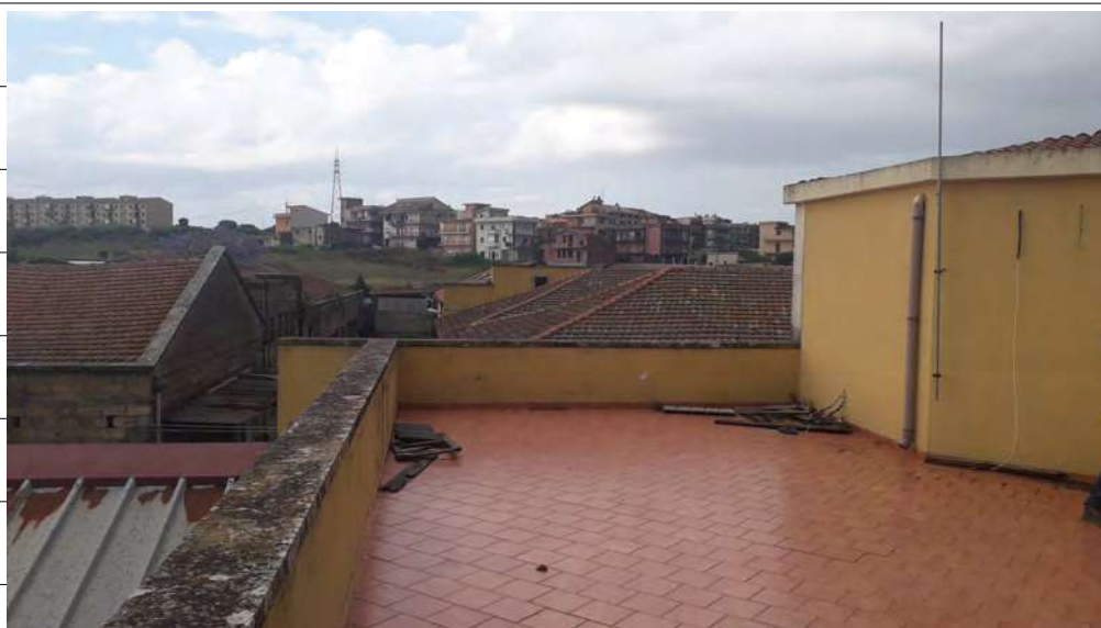
Foto n.31: immagine esterna della terrazza ubicata al piano secondo e raggiungibile dal corpo scala.
