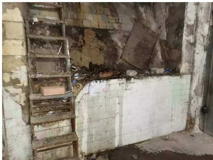
Stato di manutenzione scadente uscita d'emergenza nelle corsie di manovra
