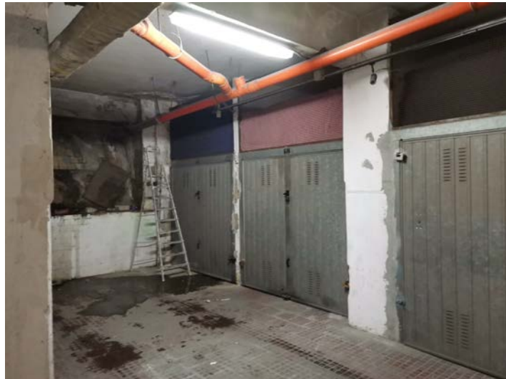
Stato di manutenzione scadente nelle corsie di manovra
