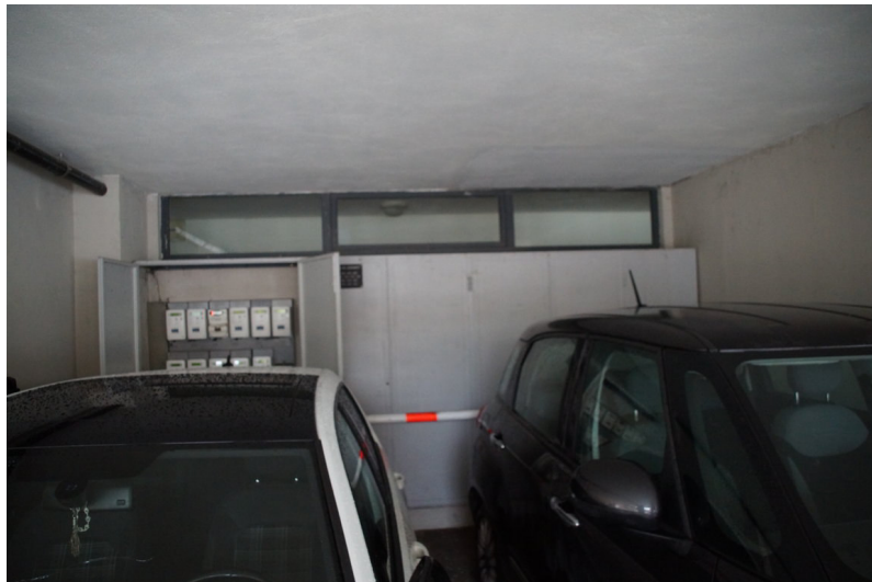
Foto n°16: particolare dell'alloggiamento dei contatori della luce posti lungo il piano terra dello stabile nella parte esposta a Sud.
