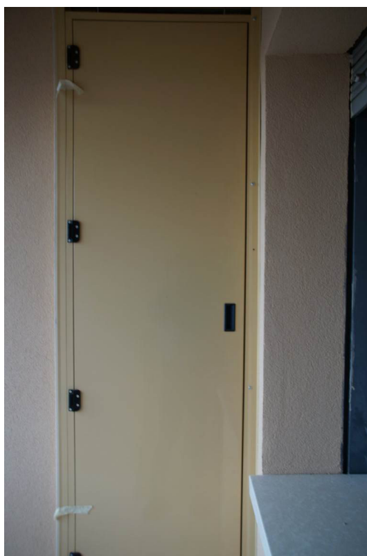
Foto n°12: particolare dell'alloggiamento della caldaia a gas metano posta nella terrazza.
