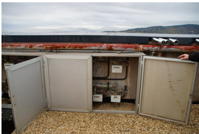
Foto n°14: particolare dell'alloggiamento dei contatori del gas posti sul tetto.
