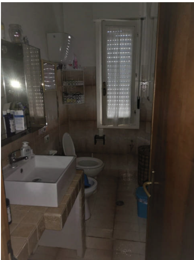
Foto 6 – Abitazione piano 1°, bagno (part. 108 sub. 7)
