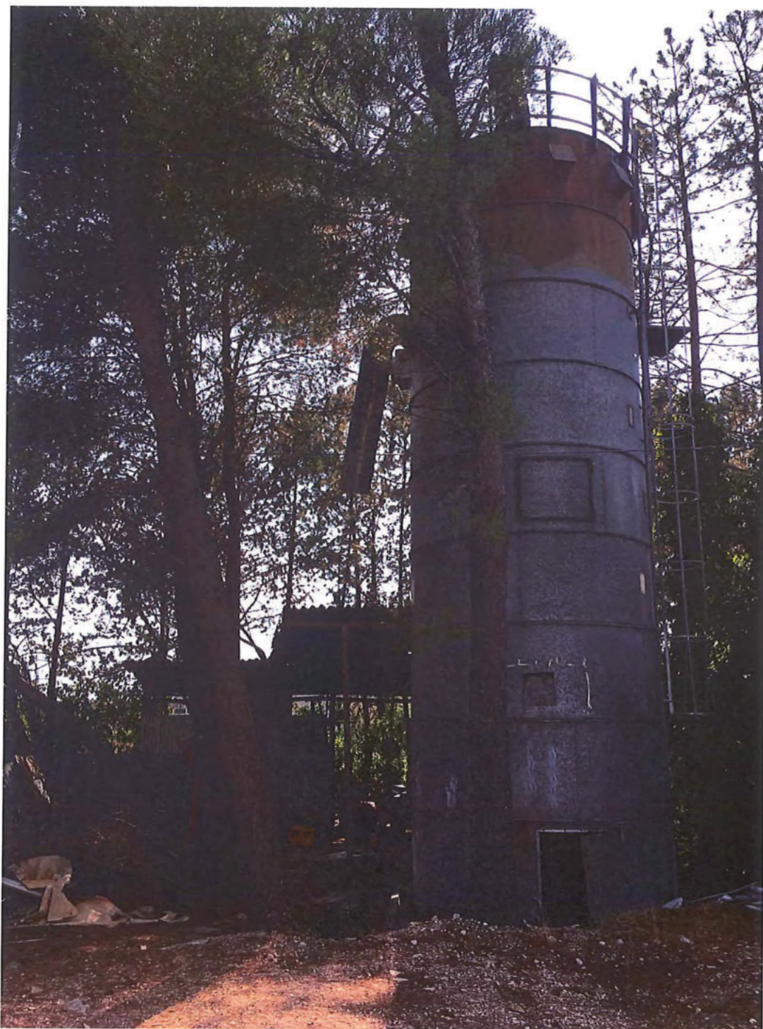
Foto n. 49 – Silo per la raccolta di trucioli e scarti di legno.
