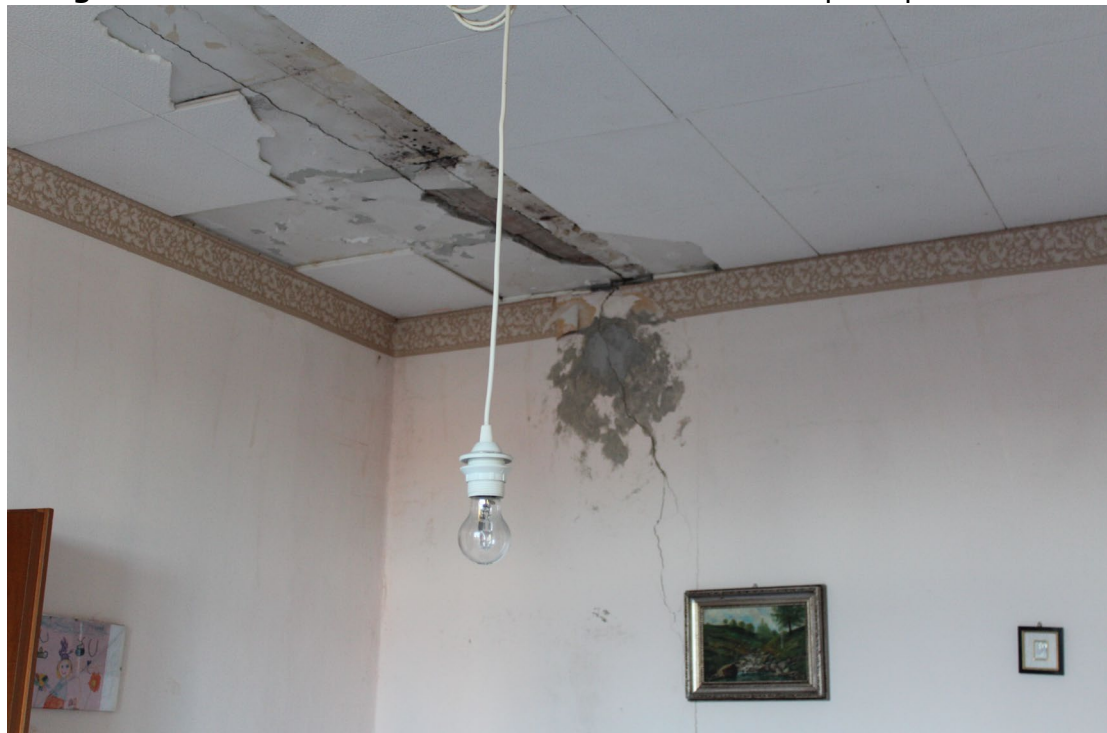
Fotogramma 10: vista dei distacchi d'intonaco riscontranti al piano primo.
