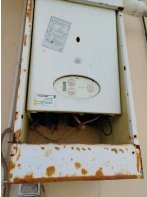
CALDAIA MURALE ESTERNA NON FUNZIONANTE E DISMESSA
