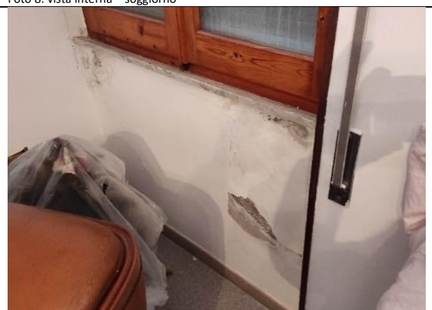
Foto 10: particolare muffa e umidità su parete esterna soggiorno
