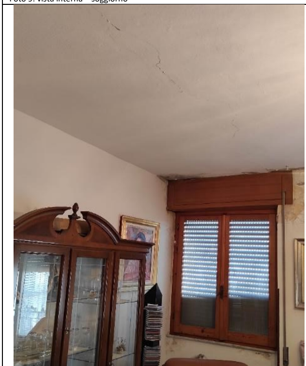
Foto 11: particolare muffa e umidità su parete esterna e crepa sul soffitto del soggiorno
