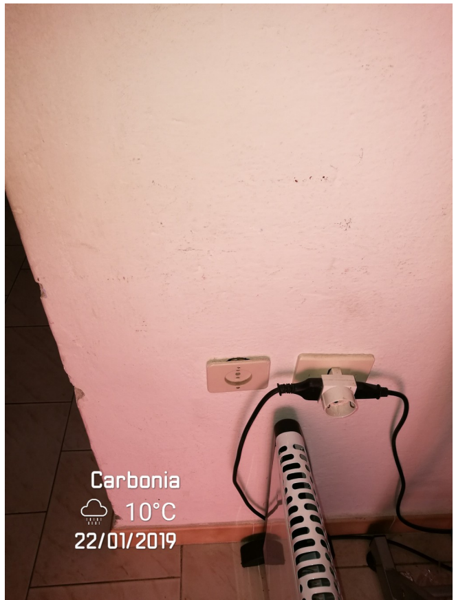
Foto 9. Particolare impianto elettrico
