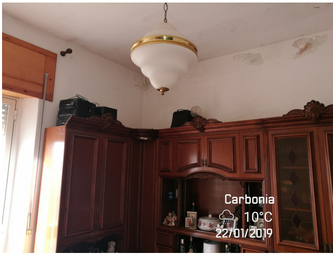
Foto 4. Soggiorno – Muffa /scrostamento intonaco
