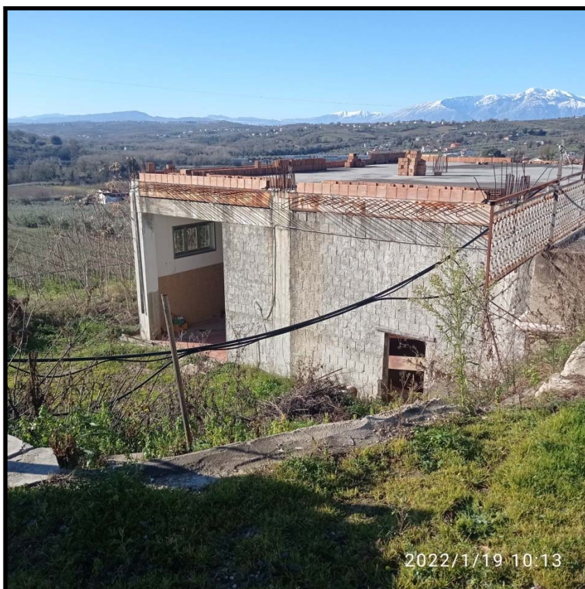
FOTO 1 – IMMOBILE FG. 7 PART. 4039 CAT. D10 OPIFICIO ADIBITO A LAVORAZIONE DI UVA DA VINO
