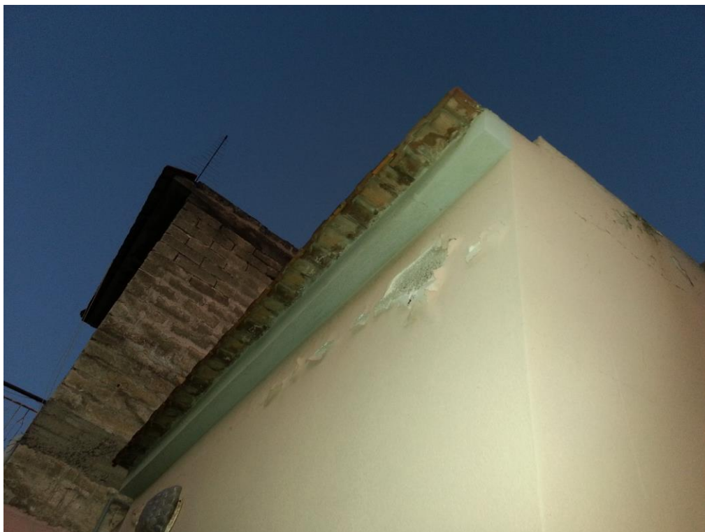
foto 12_ vista esterna del distacco d'intonaco
