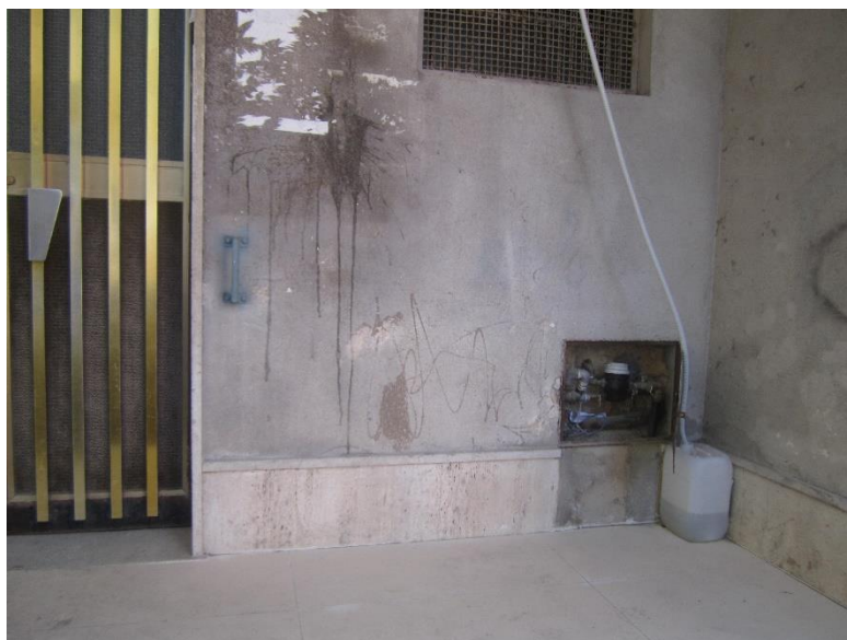
Foto 15 – Contatore acqua condominiale posto esternamente in prossimità del portone di ingresso
