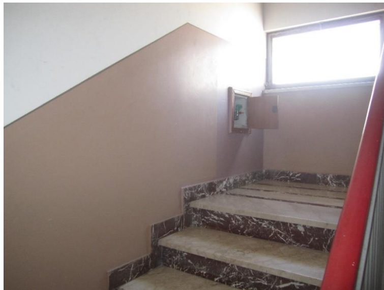
Foto 4 – Vista Contatore acqua dell'appartamento nel vano scala
