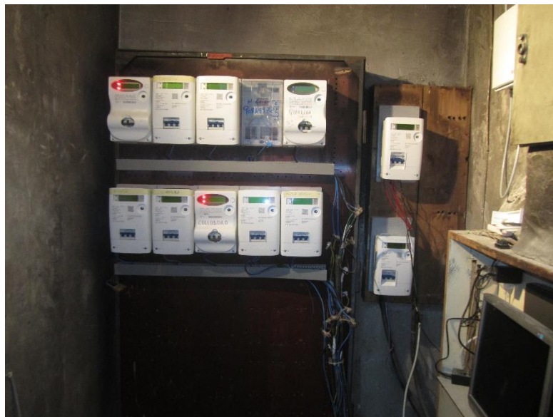
Foto 14 – sottoscala condominiale posto in ingresso dove sono alloggiati i contatori elettrici
