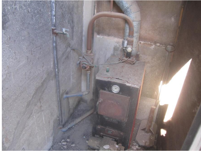
Foto 13 – Caldaia a servizio dell'appartamento oggetto di causa
