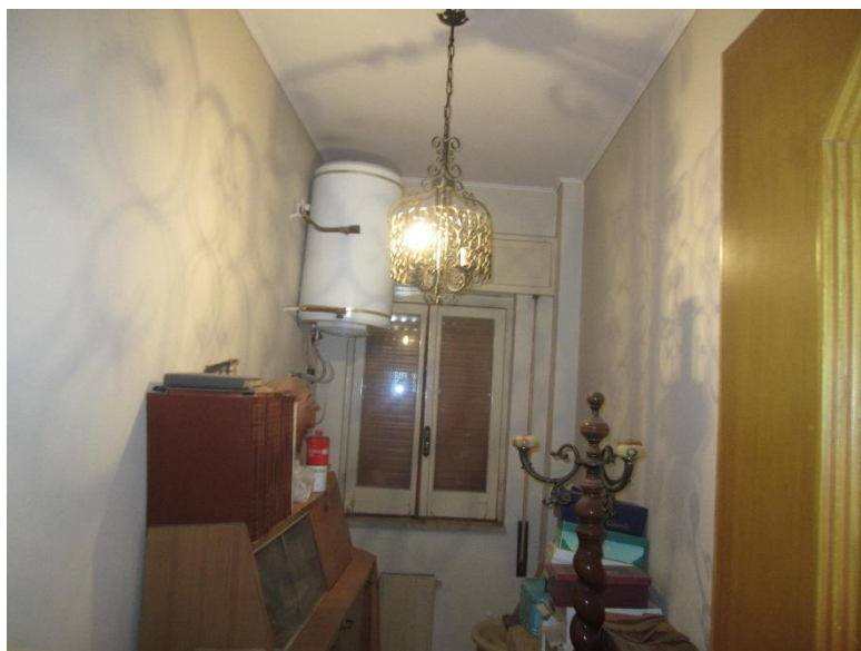
Foto 9 – Scalda bagno per acqua sanitaria
