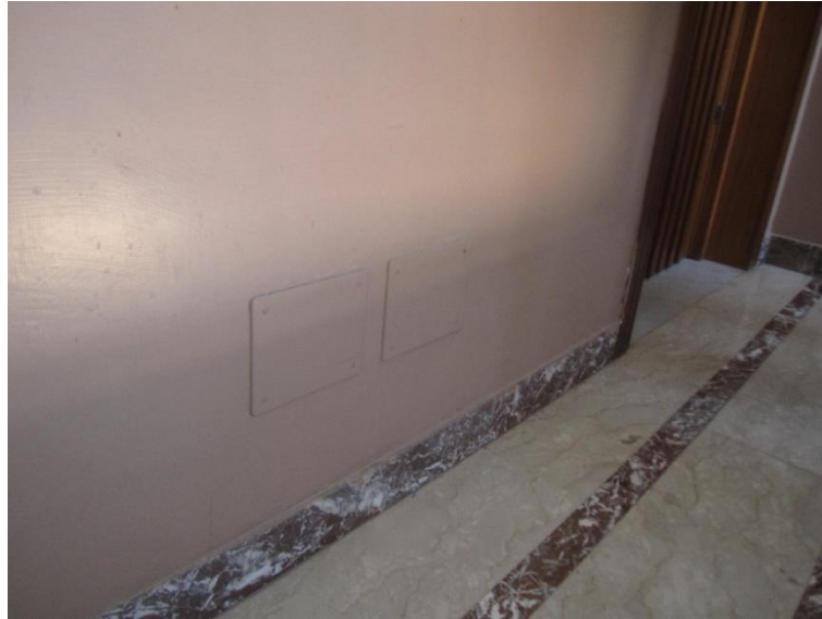
Foto 3 – Vista cassette di derivazione elettrica poste tra il portoncino di ingresso e porta ascensore nel vano scala
