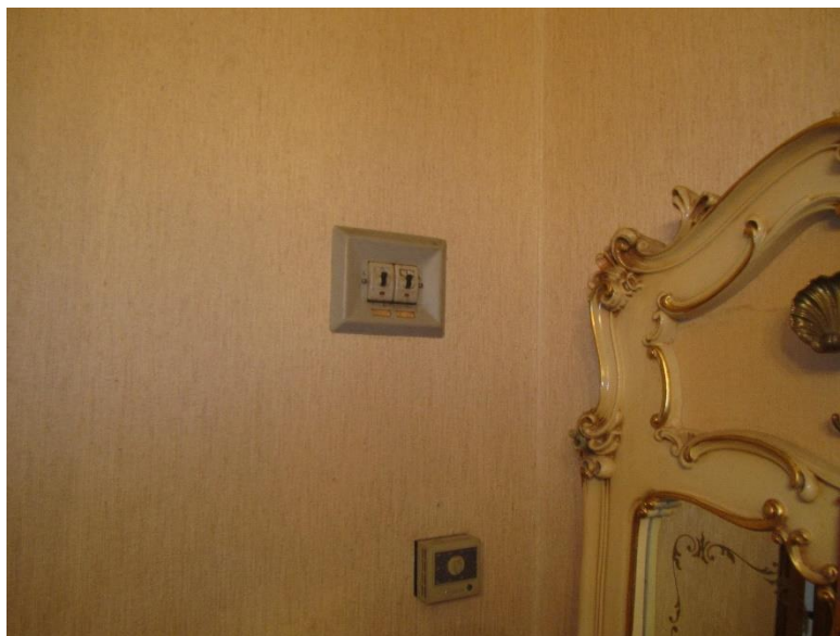
Foto 6 – Vista interruttori elettrici in corrispondenza dell'ingresso
