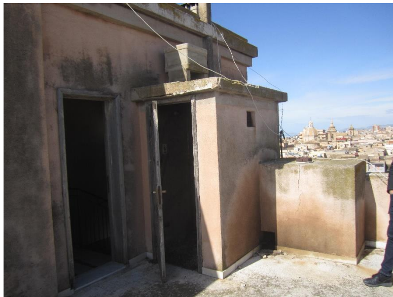
Foto 12 – Casotto per ricovero caldaia posto sulla terrazza
