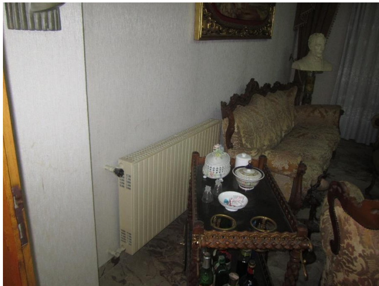
Foto 8 – Vista Radiatori impianto di riscaldamento su salone
