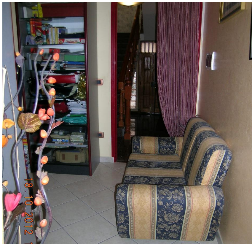
Foto 28/30: Il corridoio al piano terra difforme dal progetto in C.E.
