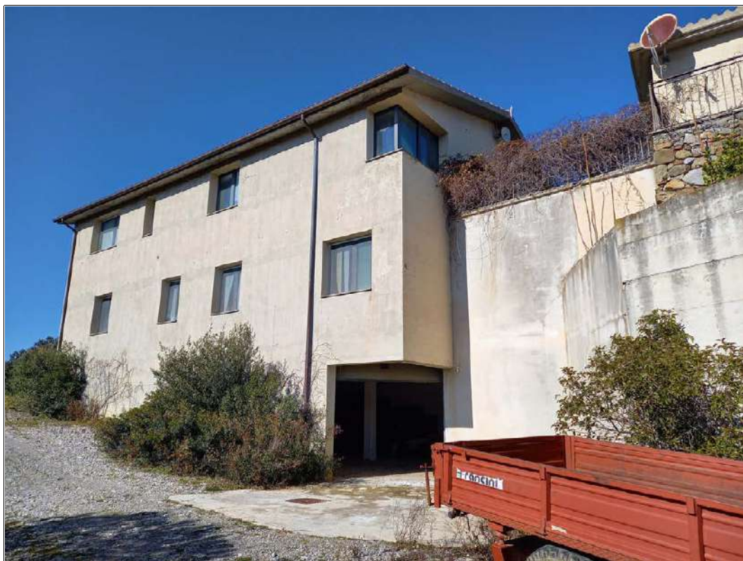
FOTO 56 – Il fronte sud del fabbricato magazzino-dispensa-lavanderia (sulla sinistra). A destra, in alto, si scorge il locale tecnico in cattive condizioni statiche e il sottostante muro di contenimento della scarpata sottostante.
