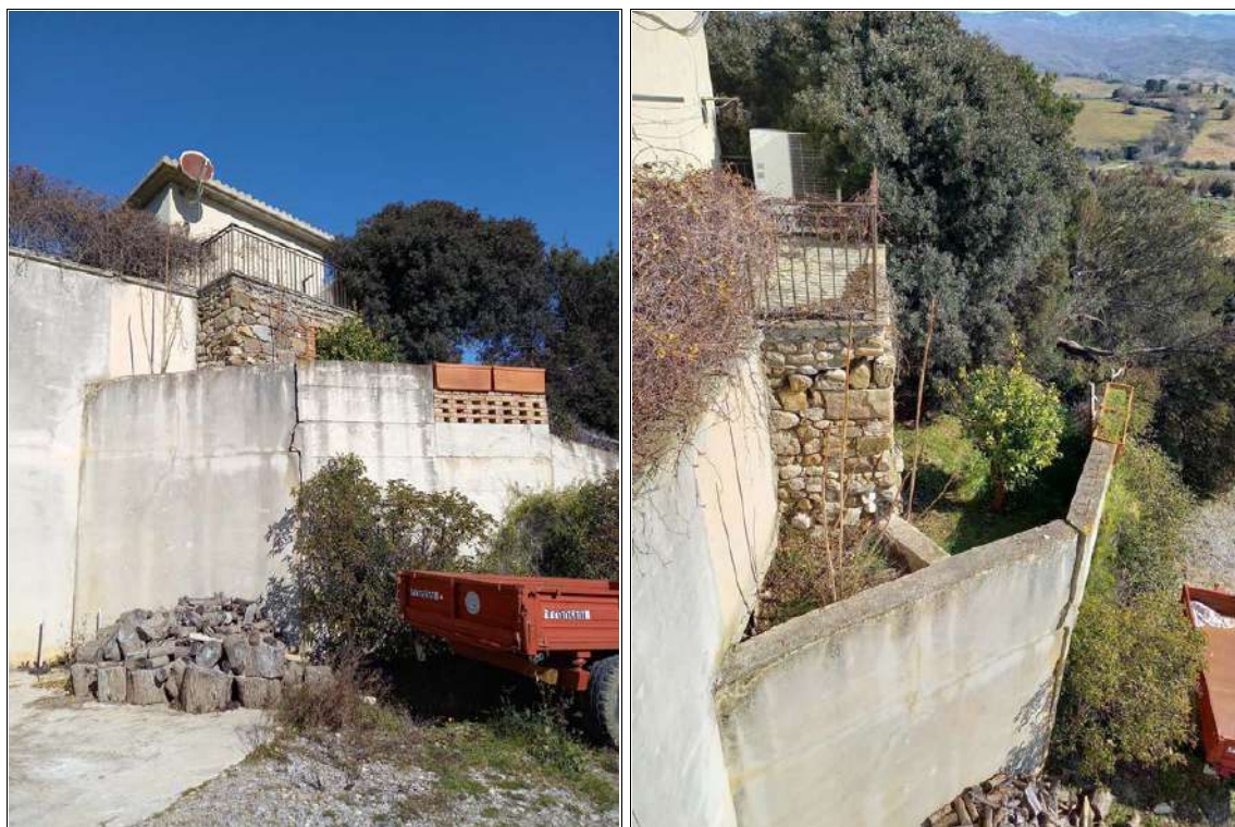
FOTO 57-58 – Altre viste della zona dissestata. In alto si scorge il locale tecnico, il sottostante vano seminterrato (in pietra a faccia vista), e in basso il muro in c.a. di contenimento della scarpata, anch'esso lesionato.
