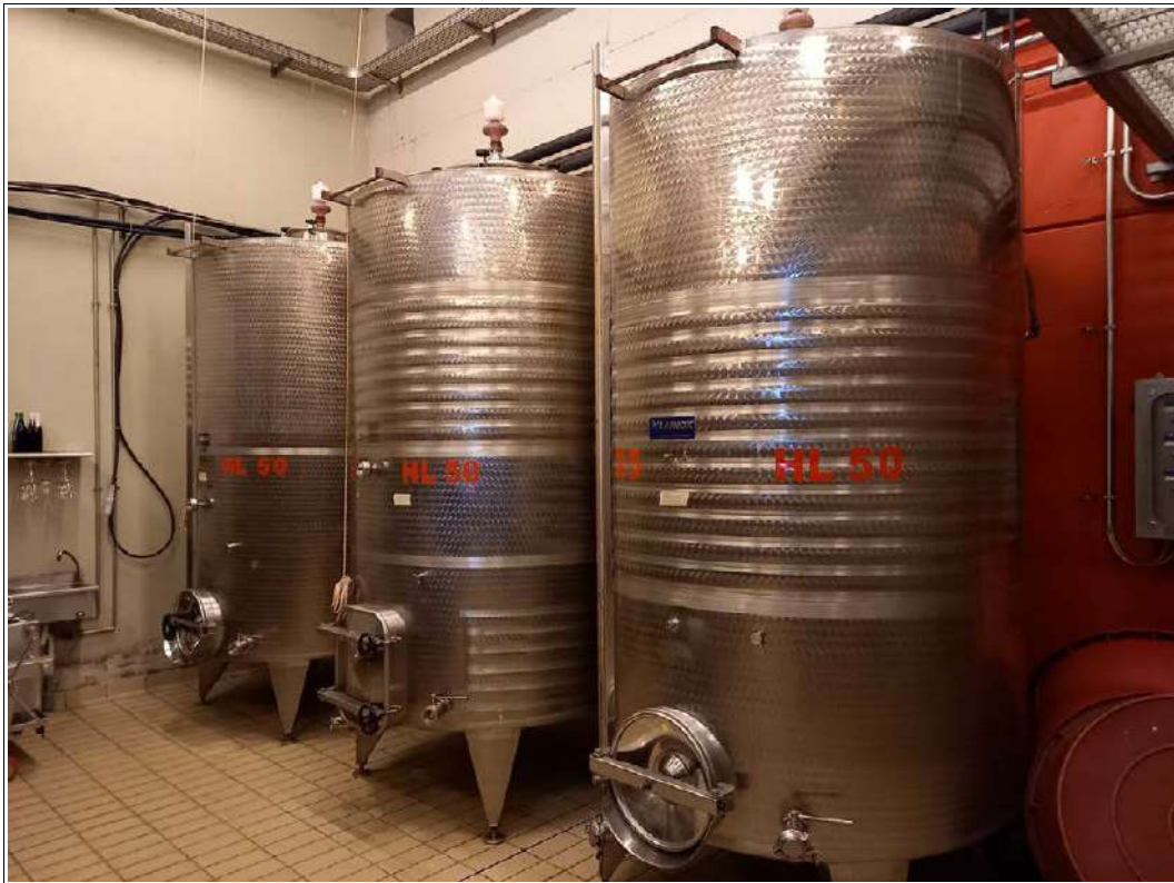
FOTO 11 – n. 3 serbatoi in acciaio inox, 50 HL, termo condizionati, marca Lainox
