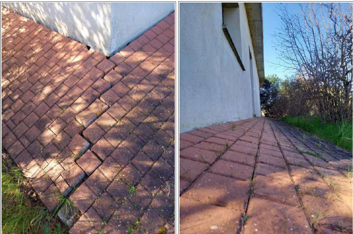
FOTO 102-103 – Cedimenti e dissesto del marciapiede esterno al blocco uffici-servizi posto al piano primo della cantina.
