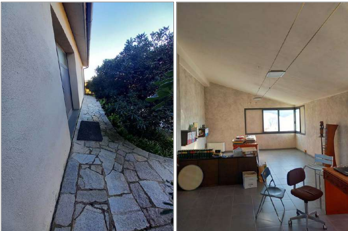
FOTO 61-62 – Il marciapiede dissestato posto sul fronte nord del fabbricato magazzino-dispensa-lavanderia; locale magazzino al p.1° dello stesso fabbricato.
