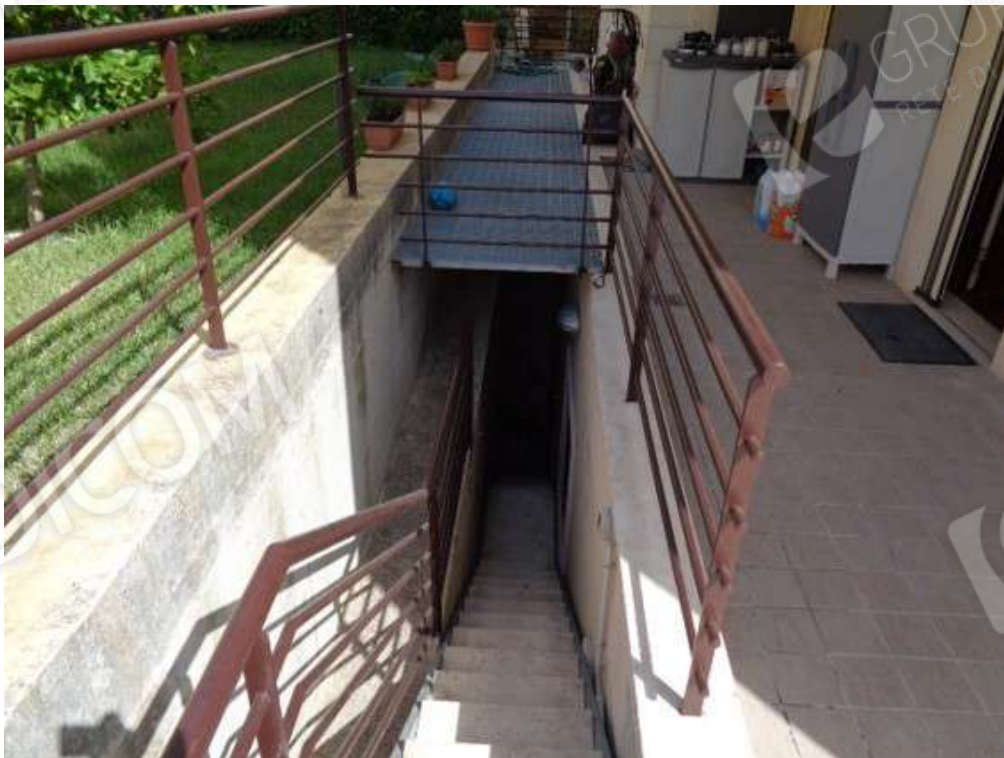
Fotografia J.44 - scala esterna in ferro tra piano terra e piano s1 a collegamento tavernetta poszionata all'interno dell'intercapedine
