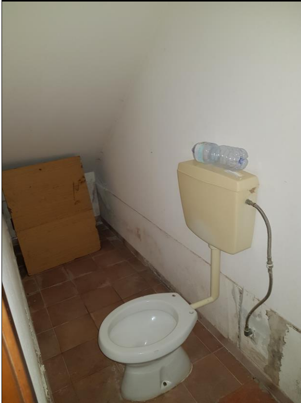
Immagine 14: Vista del WC installato nel deposito seminterrato.
