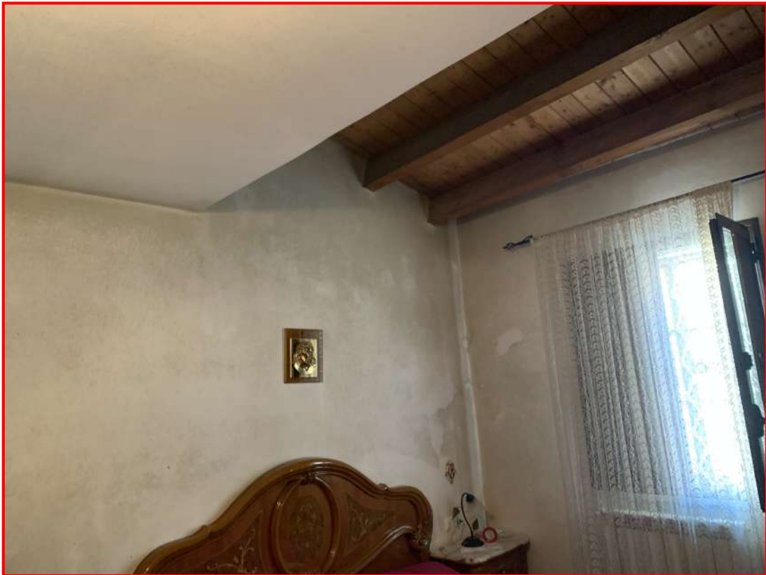
Foto n. 13 - Interni dell'unità immobiliare SUB. 3 - Piano Primo - Segni di fenomeni umidiferi diffusi su gran parte dell'ambiente.
