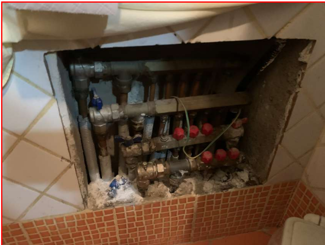
Foto n. 21 - Interni dell'unità immobiliare - Impianti - Quadro elettrico e collettore
