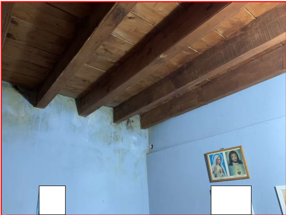
Foto n. 11 - Interni dell'unità immobiliare SUB. 3 - Piano Primo - Risultano evidenti i segni di fenomeni infiltrativi in prossimità della copertura.
