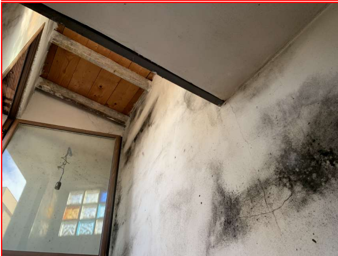
Foto n. 18 - Interni dell'unità immobiliare SUB. 0 - Piano Primo - Scala per il secondo piano (Terrazzo). Si rileva la massiccia presenza di fenomeni umidiferi.
