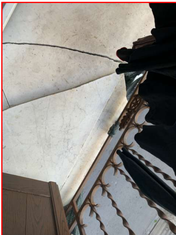
Foto n. 14 - Interni dell'unità immobiliare SUB. 3 - Piano Primo - Si rilevano gravi lesioni ai mattoni di marmo del balcone.
