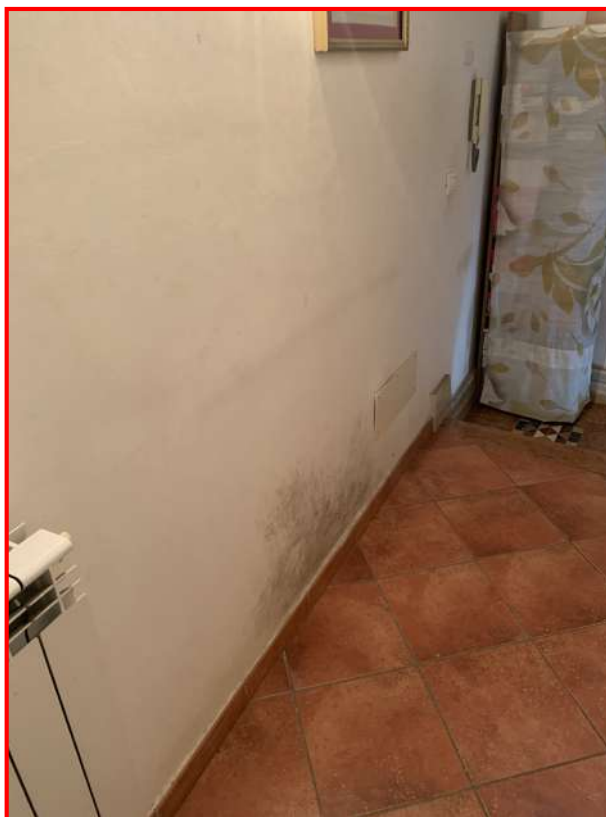
Foto n. 10 - Interni dell'unità immobiliare SUB. 0 - Piano Primo - Presenti segni di umidità di risalita
