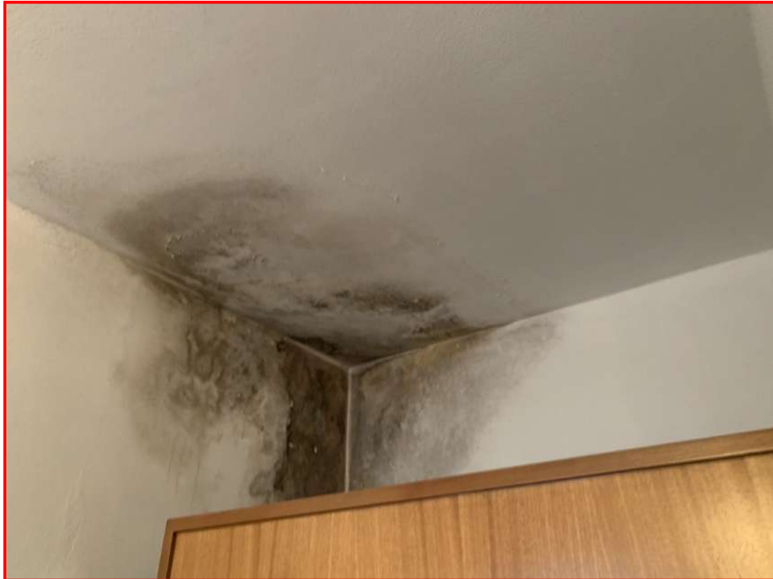
Foto n. 8 - Interni dell'unità immobiliare SUB. 1 - Piano Terra - vano destinato al servizio igienico. Si rileva la massiccia presenza di fenomeni infiltrativi.
