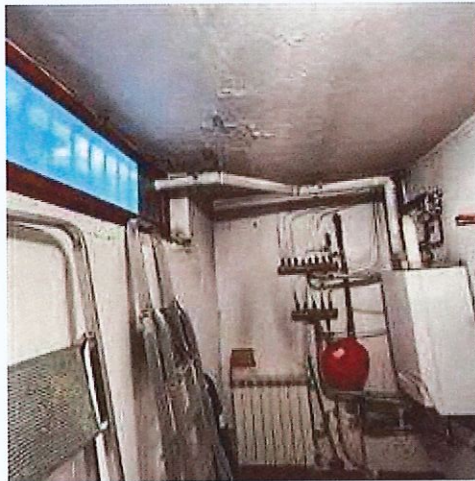
Locale tecnico al piano scantinato
