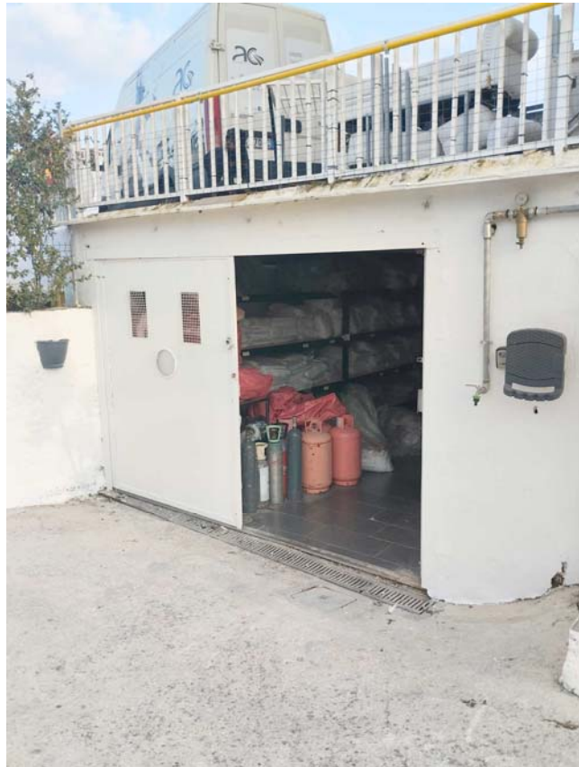
Foto 04. Accesso al Locale Deposito Sub.5
