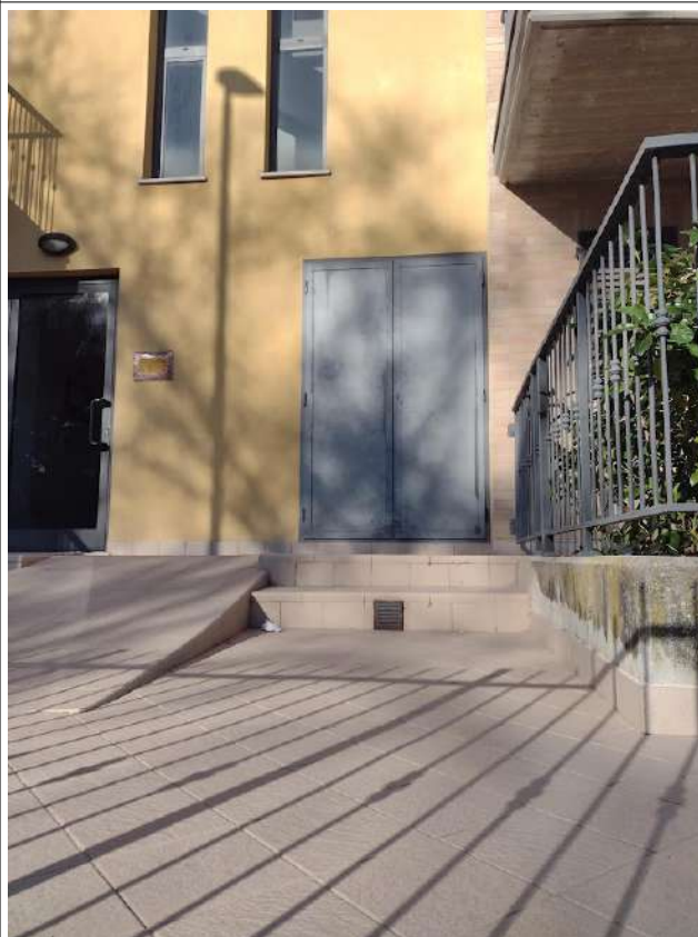
Quadro contatori condominio
