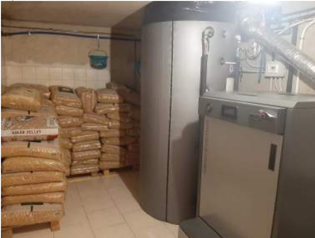
Foto n. 12. Vista interno unità immobiliare A (Lotto n. 1), Comune di Perugia, Foglio n. 174, Part. n. 122 Sub 5, piano interrato (S1), locale fondo n. 2 (è presente la caldaia alimentata con pellet, mediante la quale viene riscaldato l'intero immobile pignorato)
