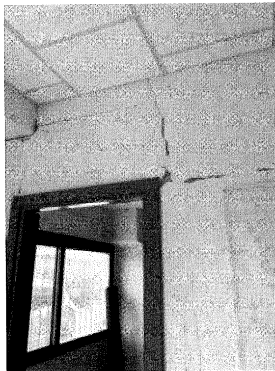
Vista lesioni sulle tamponature di gas beton.
