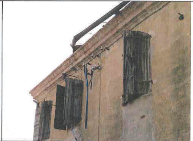
Foto n°232: Stato di conservazione precario
