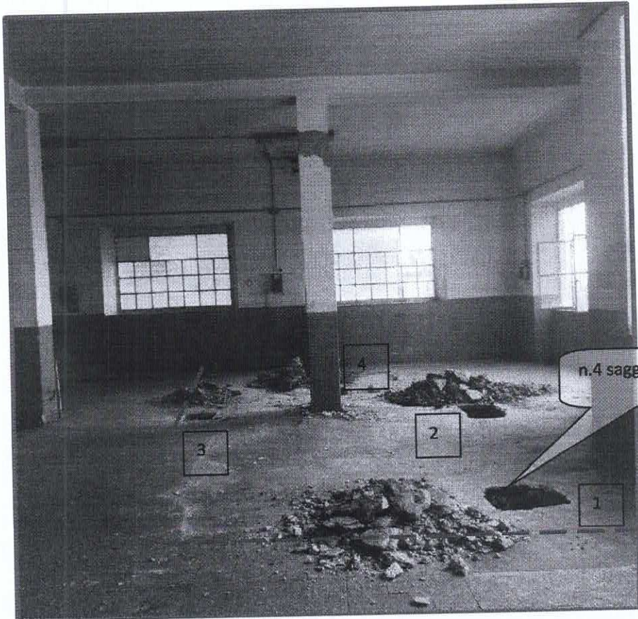
Zona del Garage, con evidenza del solaio che ha subito un abbassamento, prima dei saggi e dopo i saggi
