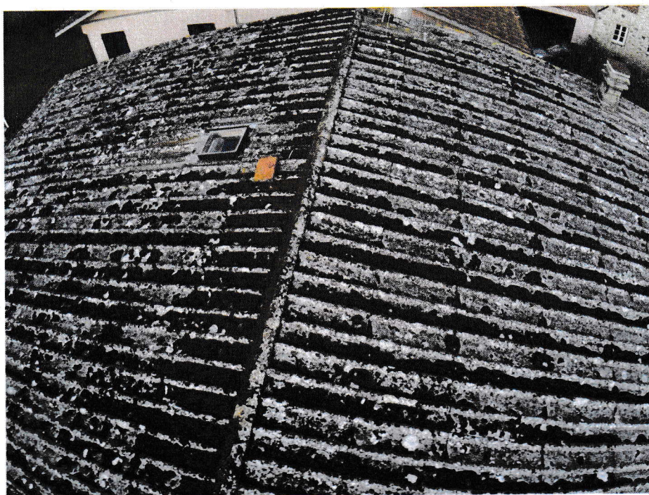
Foto 4- Particolari stato manutenzione copertura
