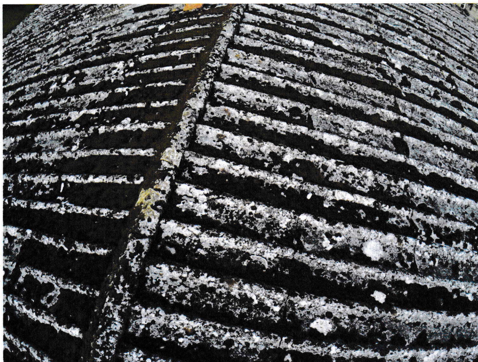
Foto 5 – Particolari stato manutenzione copertura
