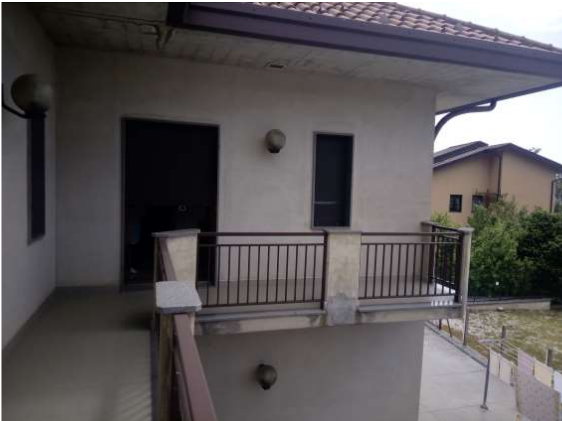
Foto 22) Balcone piano primo
