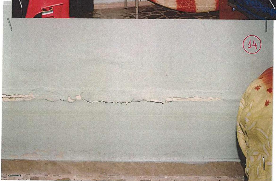
DANNI DA UMIDITA'
