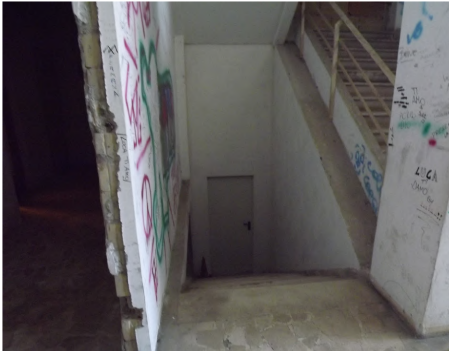
Rampa a scendere dal piano secondo livello seminterrato est con porta taglia fuoco
