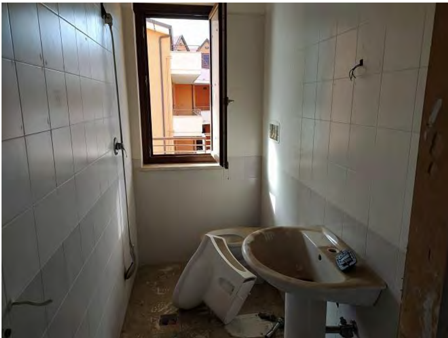
FOTO N. 26 – W.C. dell'appartamento sub. 11
