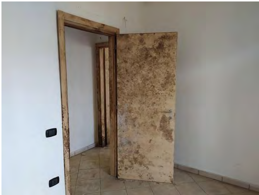
FOTO N. 14 – Una delle porte interne danneggiate dall'umidità
