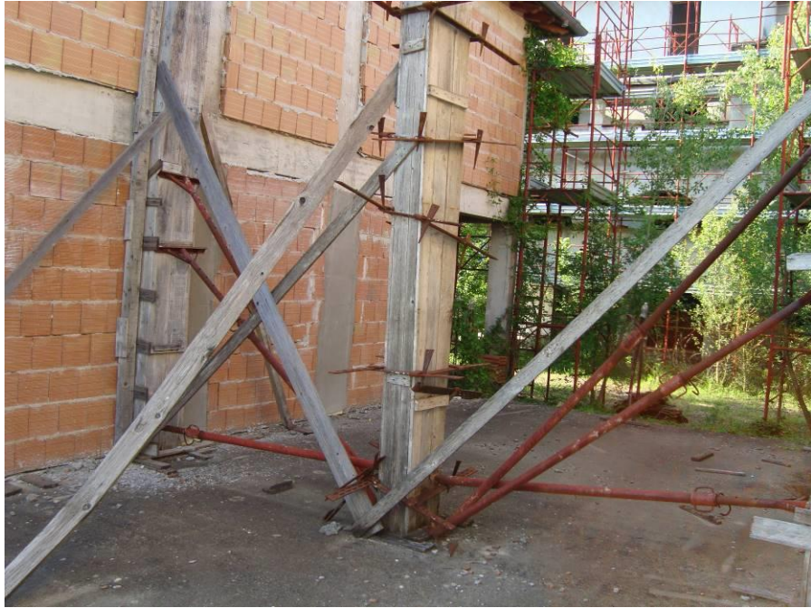
FIG. 17- VISTA PORZIONE NON REALIZZATA CARPORT ADIACENTE APP.N. 3
