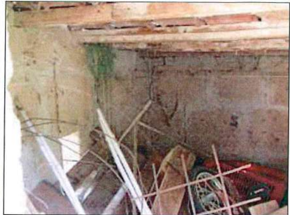
Fabbricato fatiscente: interno
