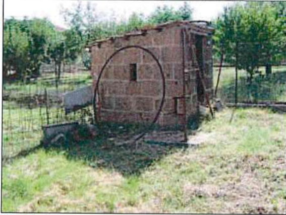
Fabbricato fatiscente ex p.lla 202 soppressa Da Nord verso Sud
