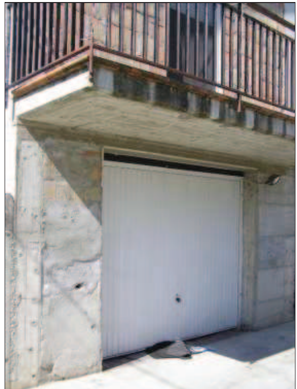
Porta basculante per l' accesso carrabile dal bene D al bene A
