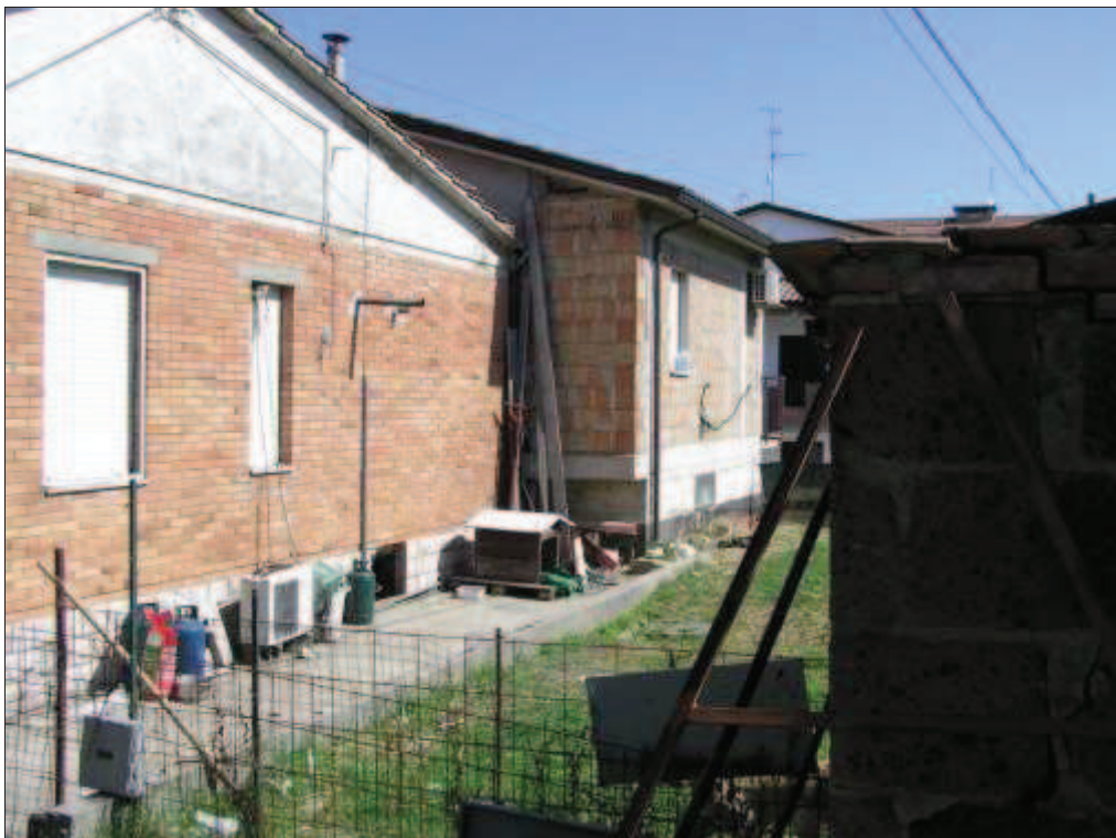
A sinistra: Bene B, nucleo originario, lato verso Est. Al centro: Bene B, ampliamento, lato verso Est. A destra: piccolo fabbricato fatiscente non censibile (ex p.lla 202 soppressa). Da Sud verso Nord.
