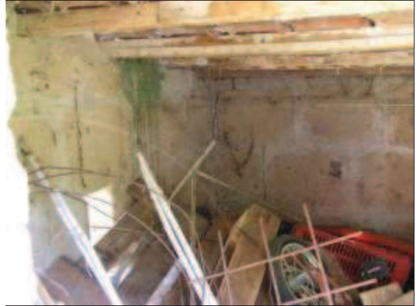
Fabbricato fatiscente: interno
